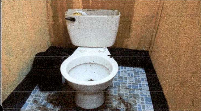
Foto 1: Baños quebrados y con escape de agua
