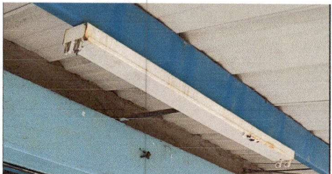
Foto 6: Sistema eléctrico deteriorado y sin focos
